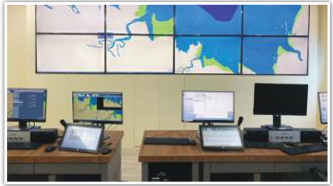
Bilik Kawalan untuk Sistem Pengurusan Trafik Kapal (VTMS). The Control Room of Vessel Traffic Management System (VTMS).
